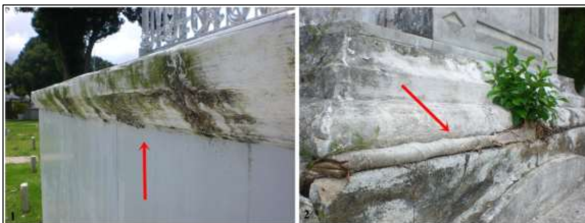
Figura 8: Patologias de ordem biológica 1. Alga ; 2. Planta
