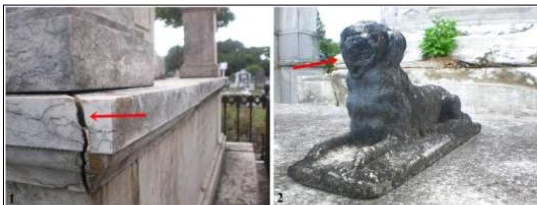
Figura 5: Patologias de ordem física 1. Rachadura; 2. Deformação. Fonte: Gisele Costa, 2014
