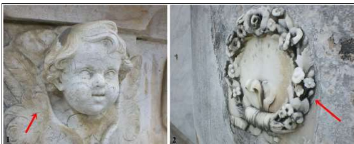
Figura 7: Patologias de ordem química
