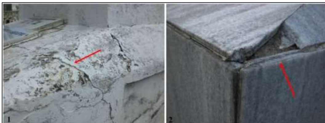
Figura 6: Patologias de ordem física 1. Destacado; 2. Fratura seguida de perda. Fonte: Gisele Costa, 2014
